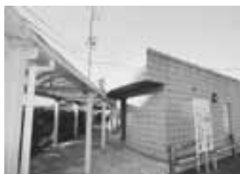
改善が望まれる公衆トイレ
