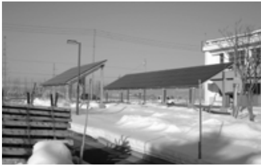
平賀西中学校に設置された太陽光発電パネル
