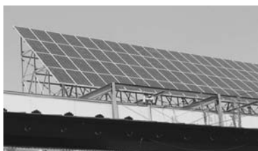
市役所裏に設置してある太陽光発電システム。今回の補正で、市内全小中学校に設置されます。
