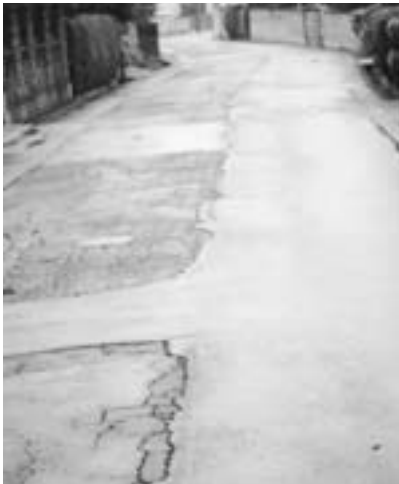
片側だけひび割れ、でこぼこが続いている金屋の道路。
